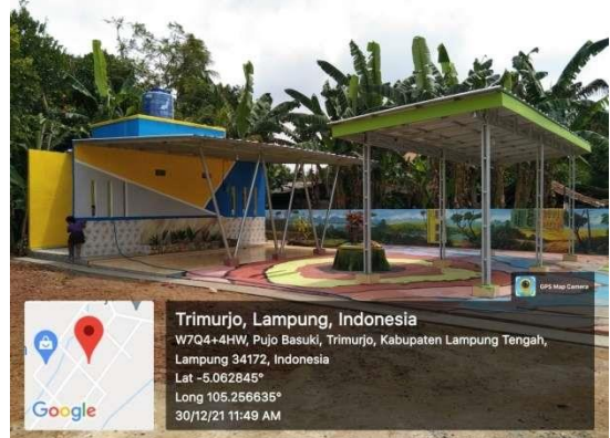
Gambar 25. Hasil Pembangunan IPAL Komunal di Kampung Pujo Basuki Kecamatan Trimurejo Kabupaten Lamongan Tengah
