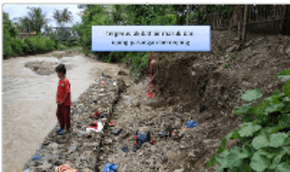
Gambar 6. Dinding Sungai Tergerus Akibat Air Masuk dari Ujung Pasangan Bronjong
