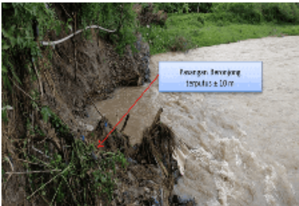
Gambar 5. Kerusakan pada Bronjong
