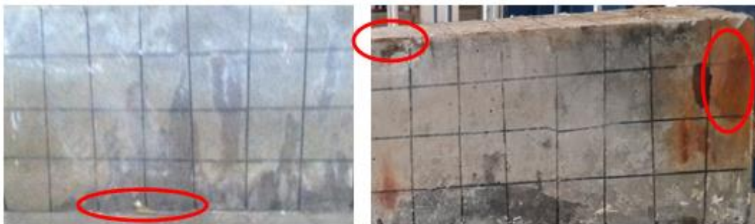
Gambar 8. Kondisi visual balok beton bertulang umur 2 tahun
