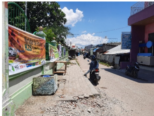
Gambar 12. Kondisi Pedestrian Ways yang kurang Terawat Foto diambil pada tanggal 01/04/2022 (Sumber: Dokumentasi Pribadi, 2022)
