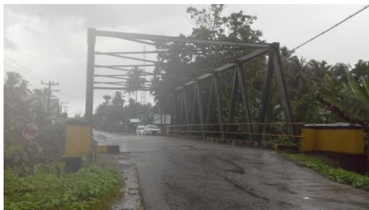
Gambar 17. Penurunan Timbunan Jalan Pendekat Jembatan Idano Mo'awu
