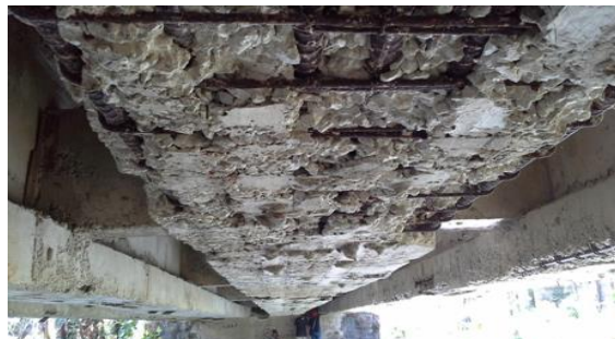
Gambar 7. Kerontokan Beton, Beton Keropos, Kualitas yang Buruk Jembatan Idano Bawonahono
