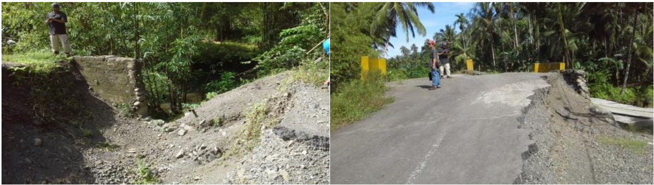
Gambar 9. Oprit di Sisi Gunung Sitoli Amblas di Seluruh Penampang Melintangnya dan Oprit di Sisi Lolowau Amblas di Sebagian Penampang Melintangnya
