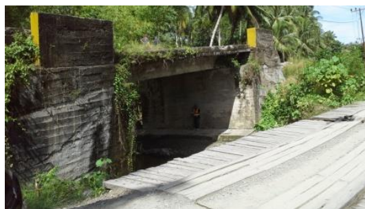
Gambar 6. Bagian Tiang Sandaran Jembatan Idano Matuho yang Rusak atau Hilang
