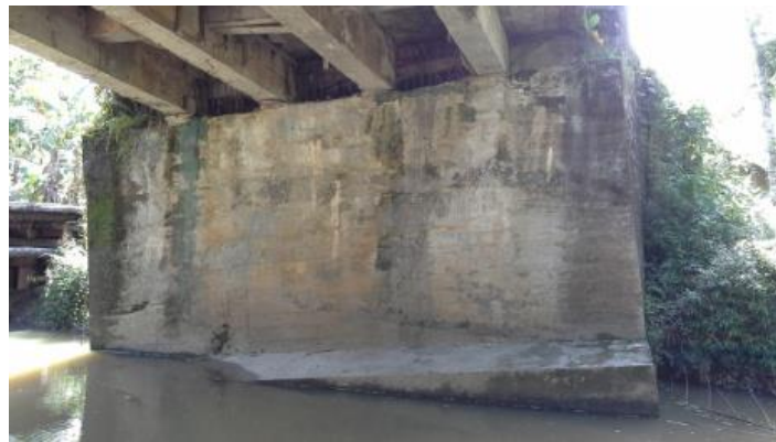
Gambar 10. Penurunan Abutment Jembatan Idano Matuho
