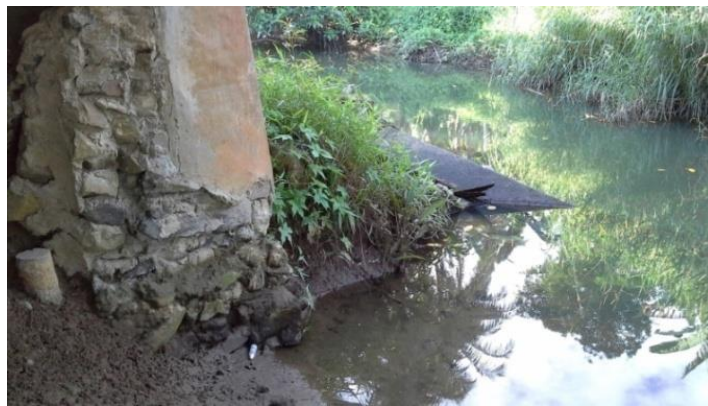
Gambar 16. Gabion yang Sudah Hilang di Bagian Bawah Jembatan Hili Gelo Sekitar Abutment
