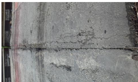
Gambar 3. Retak Aspal Akibat Pergerakan Sambungan pada Jembatan Idano Gido Sebua
