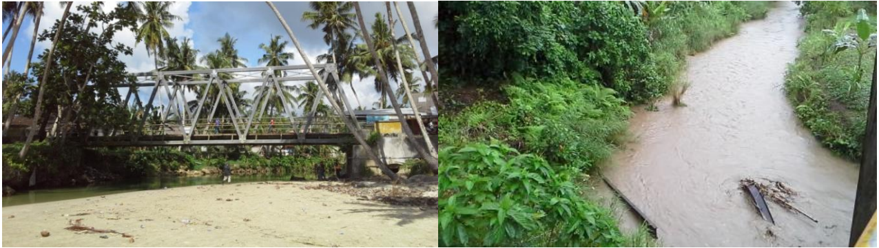
Gambar 15 Endapan pada Aliran Sungai Jembatan Idano Gewa dan Sampah pada DAS Jembatan Idano Mezawa
