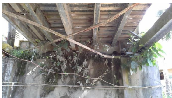
Gambar 8. Korosi pada Komponen Jembatan Idano Gewa
