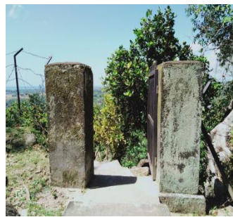
Gambar 3. Beton penyangga besi tangga
