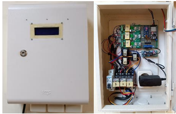
Gambar 3. Komponen Sistem Monitoring Panel Listrik dan Kontrol Listrik Kos [Sumber: Dokumentasi Percobaan Sistem]
