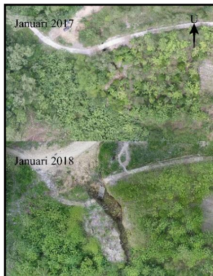
Gambar 2. Kondisi lereng sebelum dan setelah kejadian longsor
