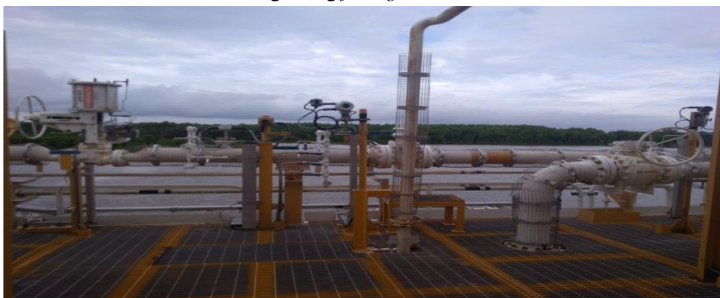
Gambar 3. Peralatan orifice meter yang berada dilokasi penelitian
