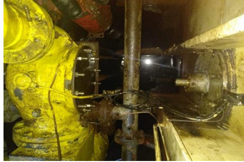
Gambar 3. Cargo pump bocor (Sumber : Hasil Observasi)
