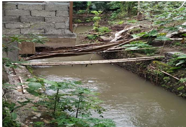
Gambar 2. Kondisi jembatan akses anak sekolah di Desa Minanga Timur
