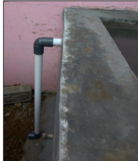
Gambar 6. Overflow untuk meluapkan air hujan yang melebihi kapasitas
