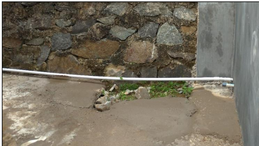
Gambar 7. Pipa outlet untuk mengalirkan air dari bak penampung
