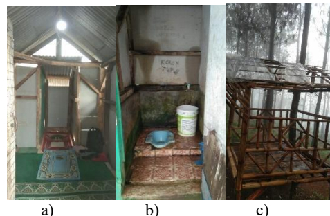
Gambar 1. Kondisi Fasilitas a) Mushola, b) Toilet, dan c) Gazebo
