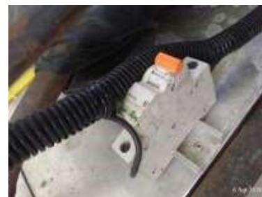
Gambar 16. Pengecekan Kondisi MCB 1 Phase 50A/63A
