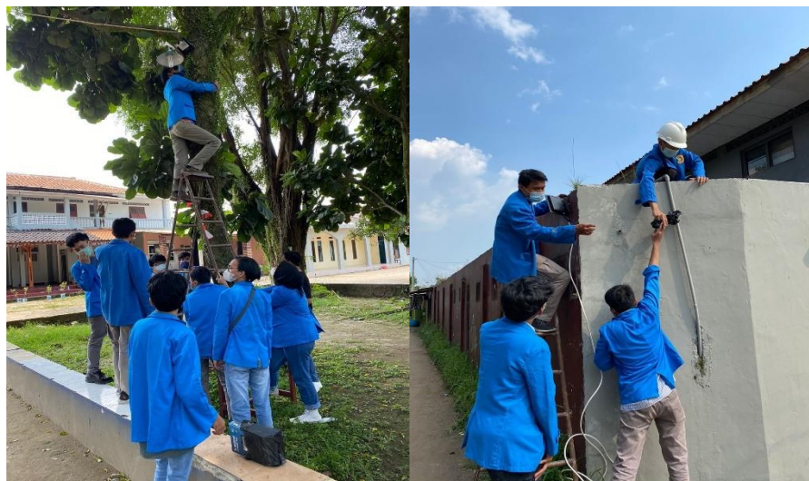
Gambar 4. Instalasi Penerangan jalan
