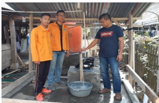
Gambar 11. Memperlihatkan kepada mitra sumur bor sistem pipa imbuah telah berfungsi dengan baik
