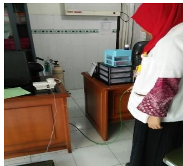
Gambar 4. Kabel kurang tertata rapi
