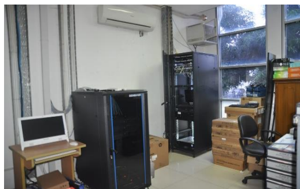
Gambar 7. Kondisi Real Ruang Server PN Jakarta Timur
