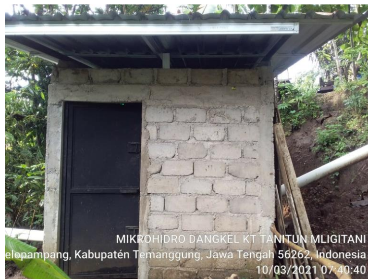
Gambar 5. Rumah pembangkit ( power house )
