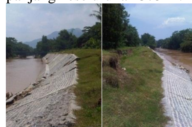
Gambar 8. Kondisi dinding penahan eksisting melalui peninjauan lapangan
