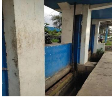
Gambar 9. Kondisi Pintu Air Kolam Retensi Danau Cimpago
