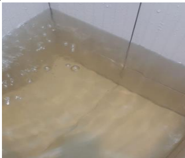
Gambar 4. Kondisi Air Baku
