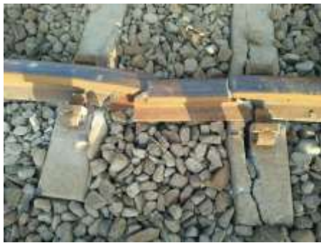
Gambar 1. Rel patah di KM 8+625
