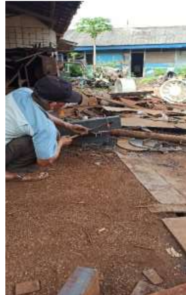
Gambar 1. Pekerja memotong besi tanpa menggunakan APD lengkap.
