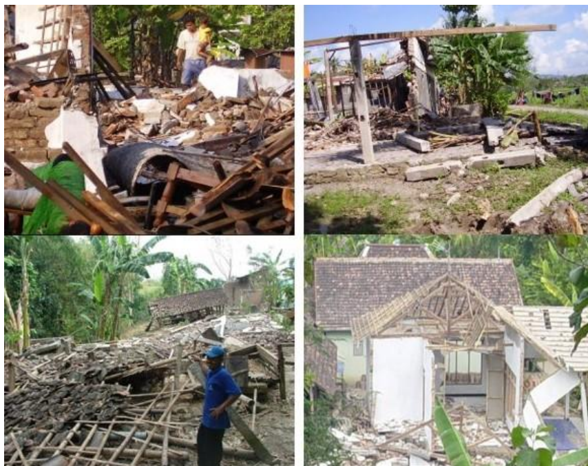
Gambar 3. Bentuk kerusakan bangunan di Yogyakarta dan Klaten akibat bencana gempa bumi Yogyakarta Tahun 2006
