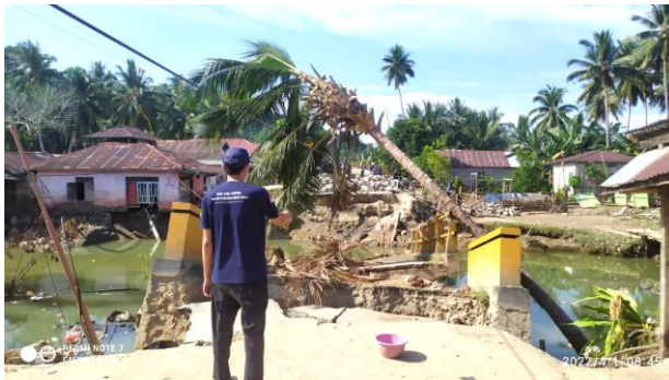
Gambar 1 Kondisi Jembatan yang rusak akibat banjir bandang di Desa Galumpang Kabupaten Tolitoli, Sulawesi Tengah.
