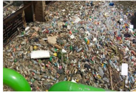
Gambar 1. Sampah plastik dan sampah lainnya yang menghalangi pintu saluran. Sumber : Hasil Dokumentasi (2020)
