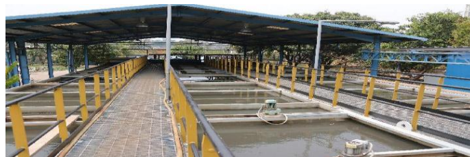
Gambar 3. Proses Penampungan Air Baku Sungai
