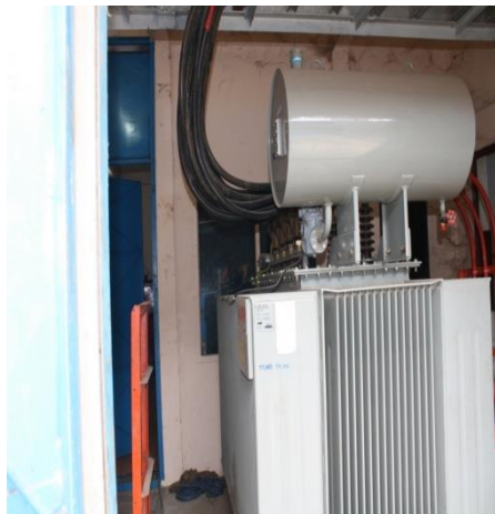
Gambar Konservator Trafo
