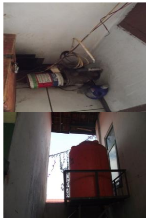
Gambar 3. Pompa air dan Tandon Air
