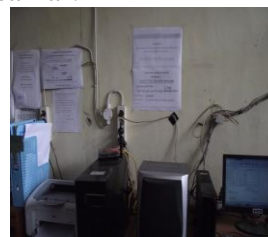
Gambar 6. Tidak ada Himbauan di Sekitar Saklar
