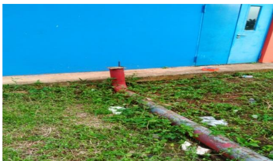
Gambar 0. Buntunya jalur pipa hydrant pillar pada Gedung Simulator STPI. (Sumber : Hasil Dokumentasi,2017)
