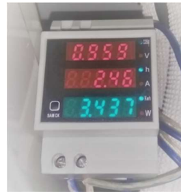
Gambar 5. Pengukuran KWh meter tanpa Evaporative Kondensor
