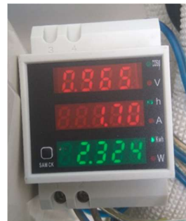
Gambar 6. Pengukuran KWh meter dengan Evaporative Kondensor
