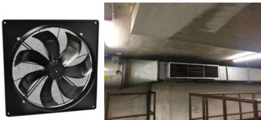
Gambar 8 Exhaust-intake fan & salurannya
