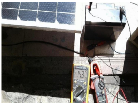
Gambar 19. Pengukuran Tegangan Dan Arus Saat Tegangan Baterai Mencapai 14,37V
