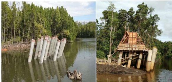
Gambar 1. Kondisi Abutment Jembatan yang sudah mengalami Kemiringan ke arah Sungai saat Tanah Urugan untuk Oprit Jembatan Mulai Diletakkan [1]
