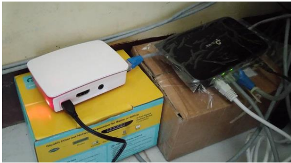
Gambar 5. Pemasangan Raspberry Pi sebagai gateway
