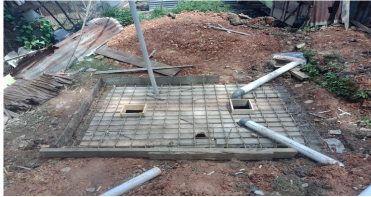
Gambar 3. Kontruksi Septik Tank Komunal
