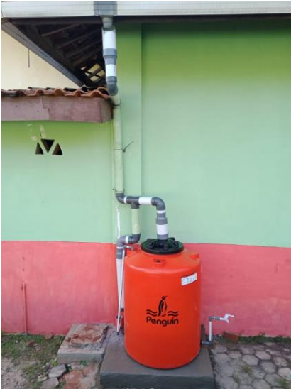
Gambar 7. Alat Panen Hujan Terpasang (Sumber :Dokumentasi Pribadi)
