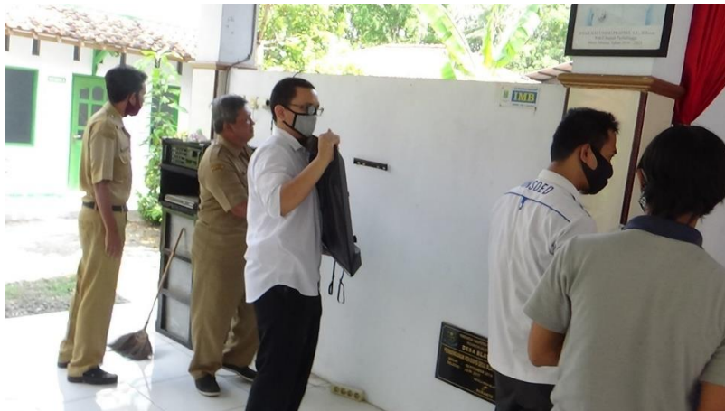
Gambar 2. Instalasi Fisik Papan Informasi Digital
