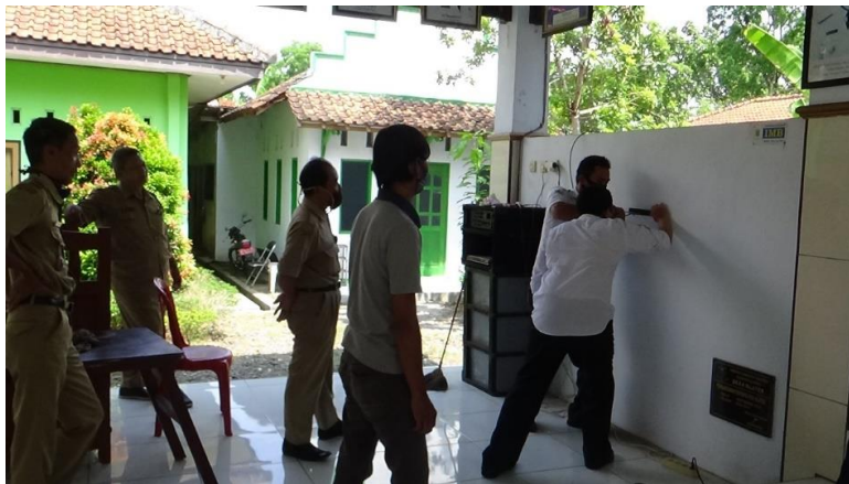
Gambar 1. Instalasi Fisik Papan Informasi Digital
