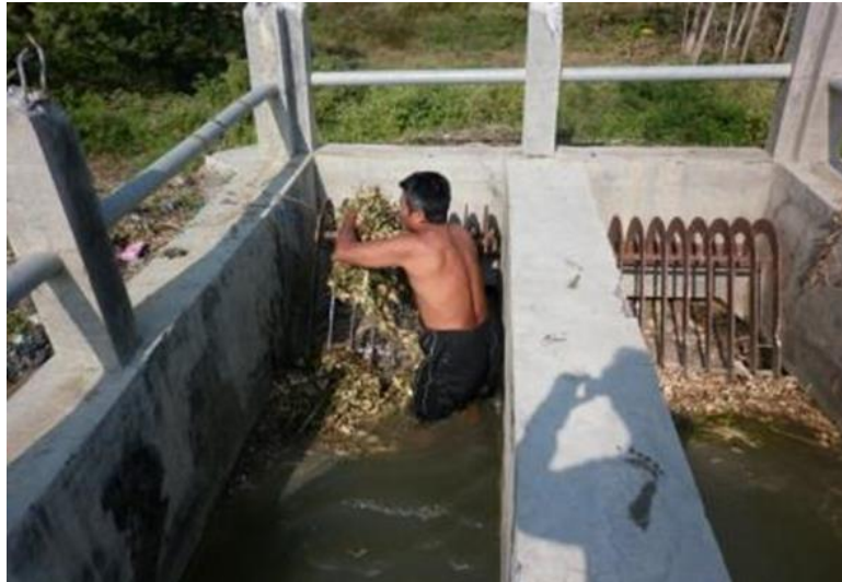
Gambar 3. Tumpukan Sampah Di Bangunan Siphon Daerah Galian.
