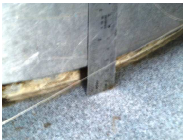
Gb.5. Tingkat Penurunan Kolom dan lantai sekitar kolom Lantai 1 C1
