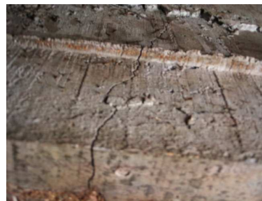
Gb.6. Retak Balok sekitar kolom B5
