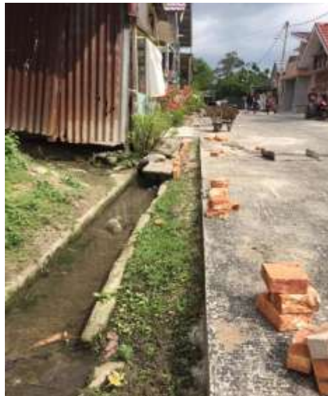
Gambar 1. Kondisi Jalan Sebelum Pelebaran
