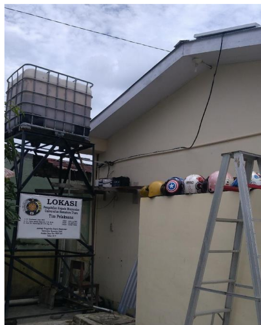
Gambar 5. Alat Penjernih Air Yang Diintegrasikan dengan Pompa Air Tenaga Surya.
