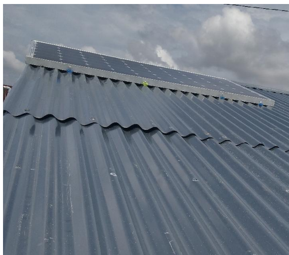
Gambar 4. Panel Surya yang diintegrasikan dengan pompa air
