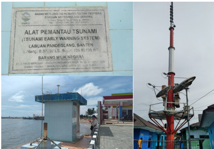
Gambar 9. Sistem peringatan dini tsunami berbasis pengukuran muka air laut di Labuan yang tidak berfungsi saat tsunami terjadi.
