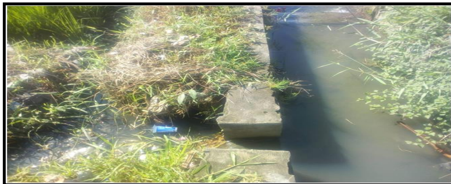
Bangunan sadap Subak Pagutan denbar
