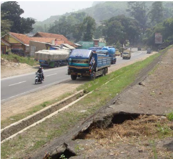
Gambar 9. Lubang pada lereng rekayasa (Foto: Zakaria, 2009).
