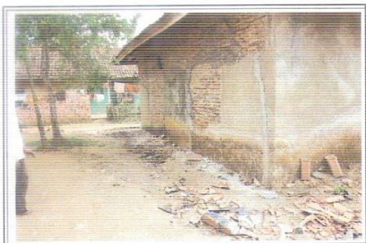
Gambar 4. Runtuhannya Dinding dan Gedung (Sumber: BMKG, 2009).
