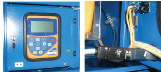
Gambar 11. Komponen terpasang pada pintu bagian dalam panel
