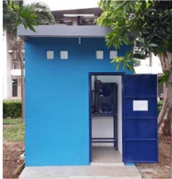
Gambar 4. Bangunan Pelindung Sistem Online Monitoring Di Sungai Ciliwung Segmen Masjid Istiqlal (S. Galih, 2016)
