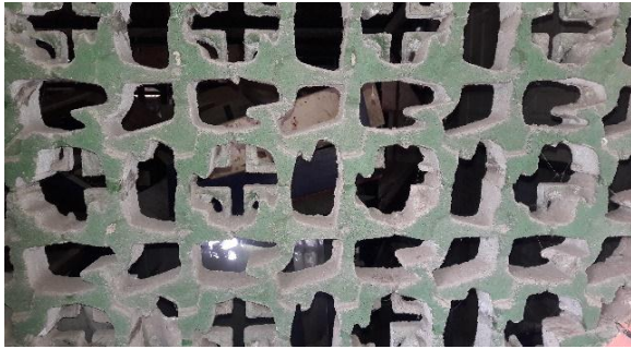
Gambar 7. Roster di dinding bangunan Wisma retreat Salam, Kab. Magelang Sumber: Dokumentasi Peneliti, 2019
